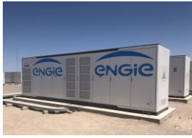
2MW / 6 MWh BESS Arica
