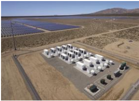
141MW / 638 MWh BESS Coya
