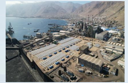
116MW / BESS Tocopilla
