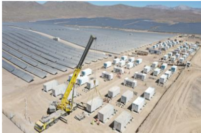
48MW BESS Los Loros
