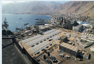
119MW / 600 MWh BESS Tocopilla
