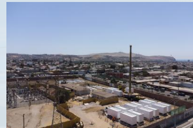
25MW / 170 MWh BESS Arica
