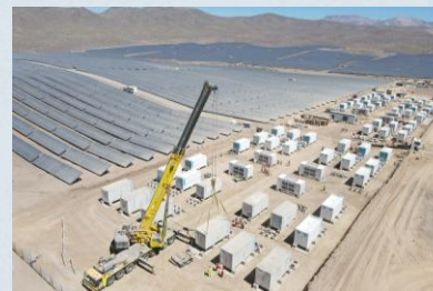
46MW / 280 MWh BESS Los Loros
