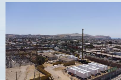
30MW / 170 MWh BESS Arica
