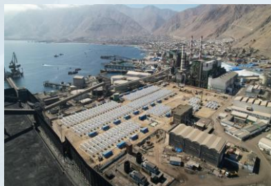
119MW / 600 MWh BESS Tocopilla
