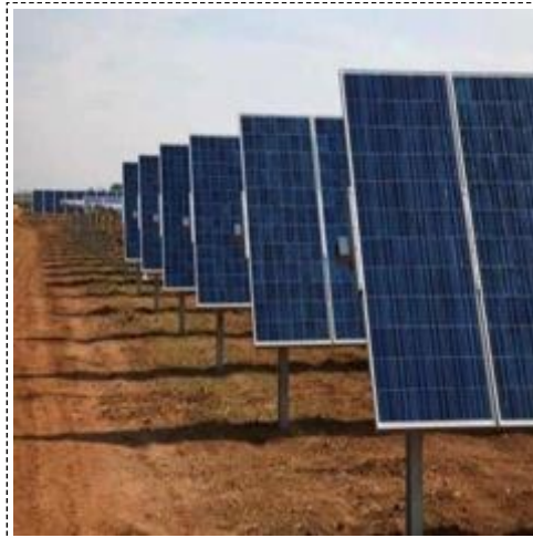
Planta solar fotovoltaica – El Aguila I y II 17 MW
